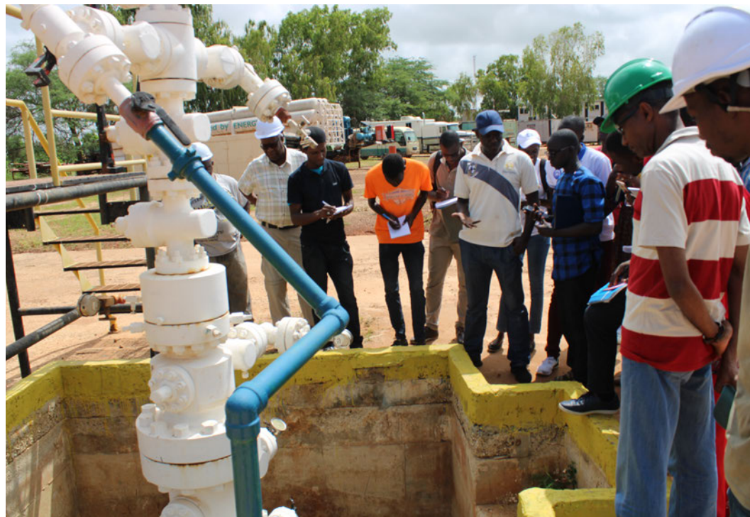
Site d'exploitation de gaz à Ngadiaga (Thiès-Sénégal) : étudiants à la rencontre d'ingénieurs pour comprendre le processus d'exploitation du gaz.
